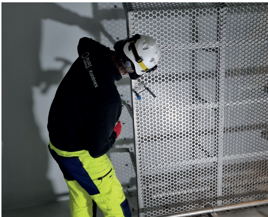
Et nylig desinfisert system er sårbart for invasjon og oppvekst av uønskede opportunistiske mikroorganismer. Desinfeksjon av RAS tar også verdifull tid fra produksjon og koster mye. Bildet viser remontering av siler i bioreaktorer etter at betongen er behandlet. Foto: Pure Salmon Technology
